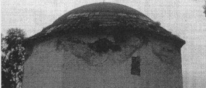
La ermita de los Dolores está sufriendo graves daños mientras le llega su restauración. :: L.M. IDEAL 29-11-11
